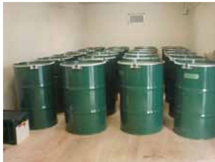
使用済み PCB 入りトランス (処分前の状況)
