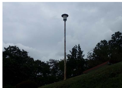
【屋外外灯老朽化】
