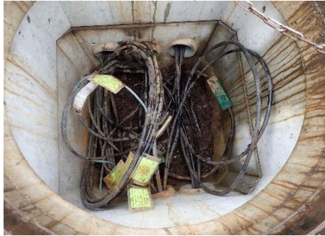
【屋外配線老朽化】
