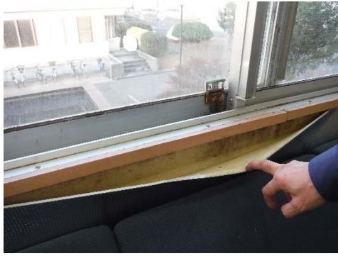
【内壁仕上材剥離】
