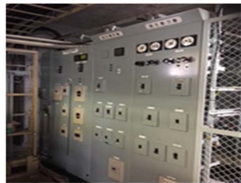
【配電設備老朽化】
