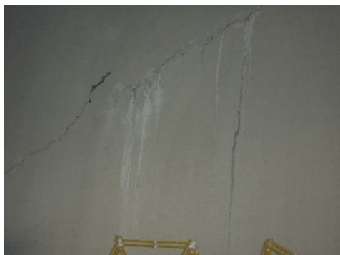
【内壁ひび割れおよび白華】
