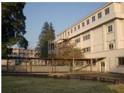
【鉄骨部材発錆】
