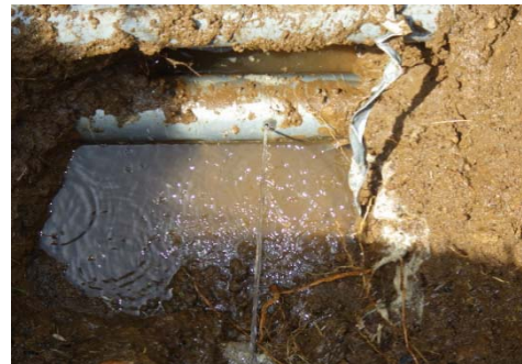
【屋外給水管破損】
