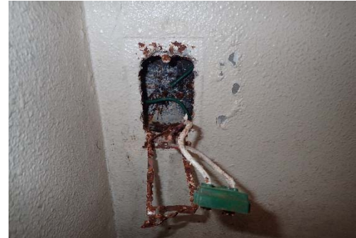
【コンセント発錆】
