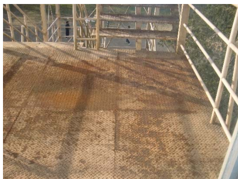
【鉄骨階段踊場発錆】
