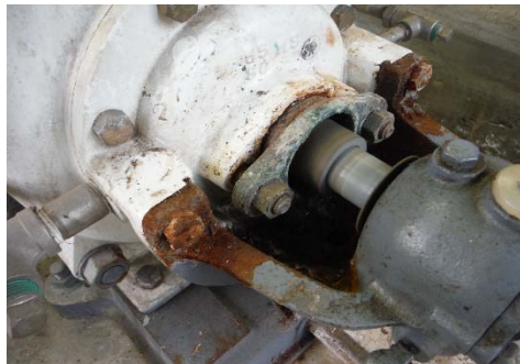
【揚水ポンプ発錆】
