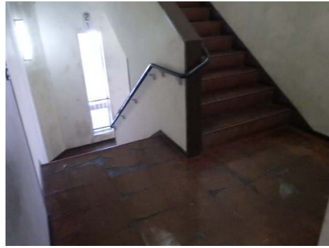
【内階段床仕上材剥離】
