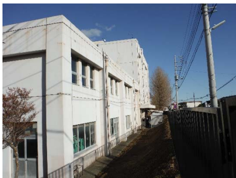
【外壁ひび割れ】
